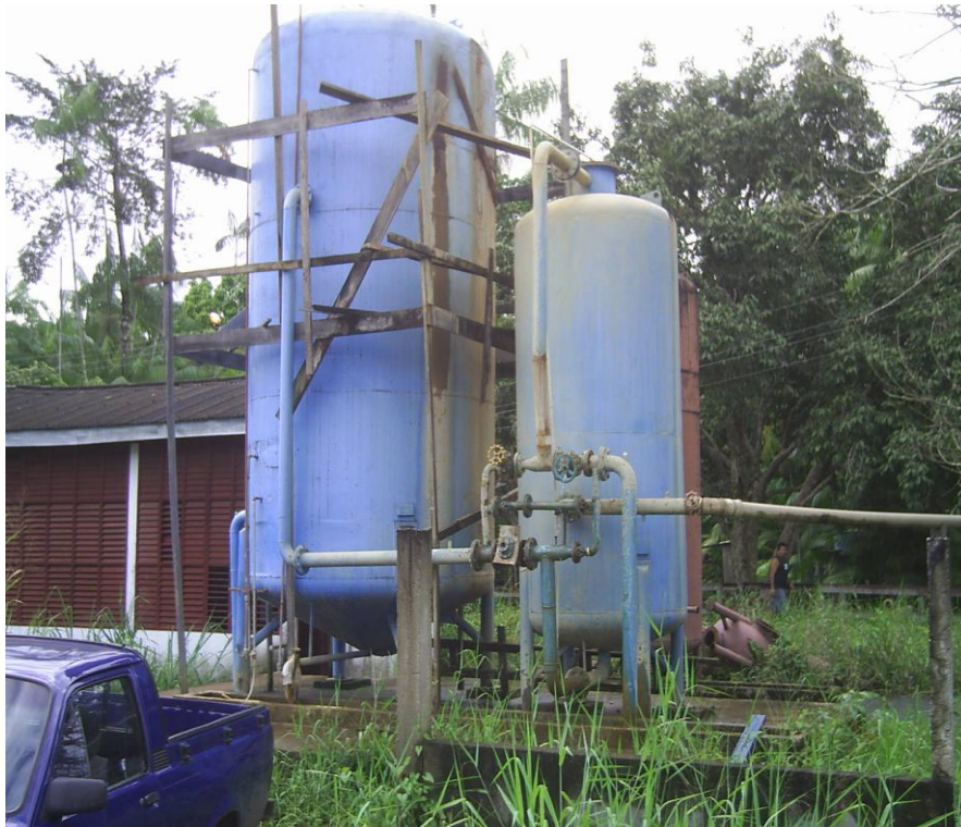
Foto 07: Ilustração das condições da subestação d'água do Elesbão. Fonte: Janilma Vilhena. (2009)
