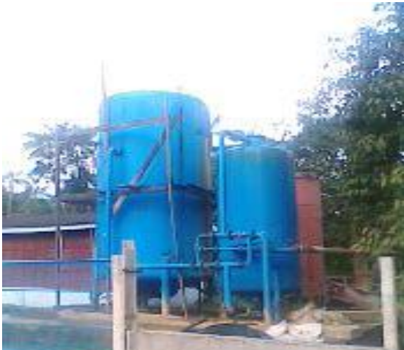
Foto 01: Subestação de Água do Distrito do Elesbão Fonte: Janilma Vilhena (2009)
