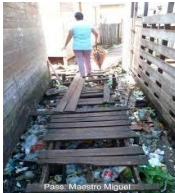
Figura 5: Acessos precários às áreas de ressaca.
