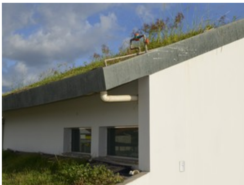
Fig. 31: imagem mostra tubulação para captação de água da chuva e irrigação do telhado verde Fonte: http://www.promosa.com.br
