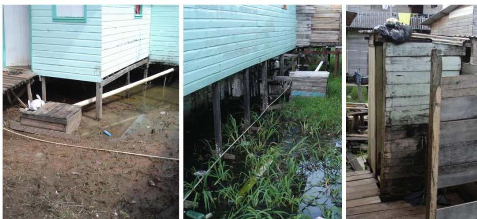
Figuras 84, 85 e 86 – Condições de destino dos dejetos sanitários
