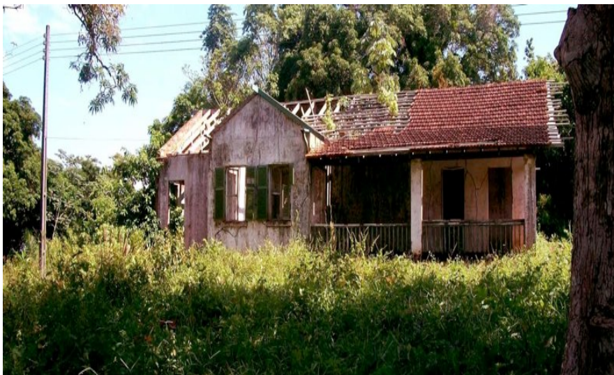
Figura 03 – Casa de Fordlândia em ruínas nos dias atuais
