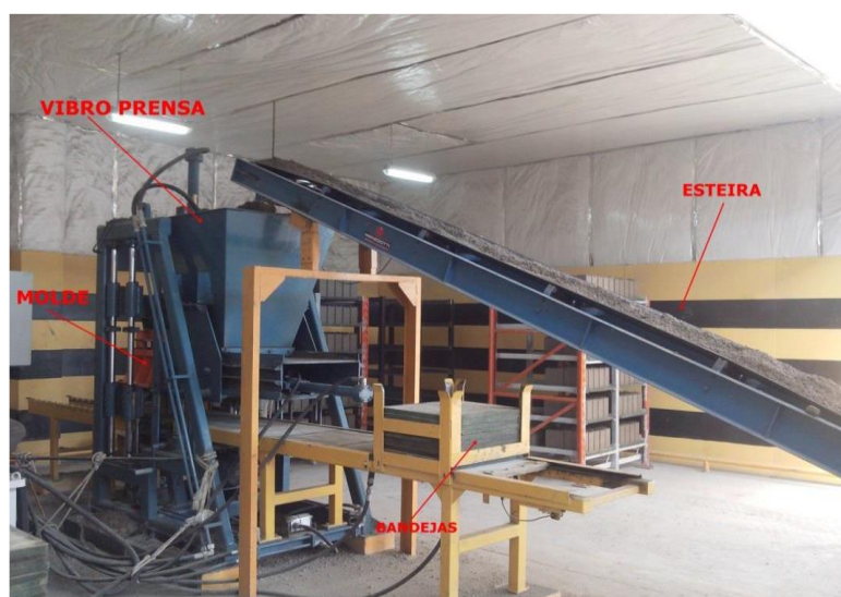
Figura 17 - Esteira transportadora. Fonte: Manual de produção de bloco da empresa Comblocos. Gabriela Lustosa (2016).
