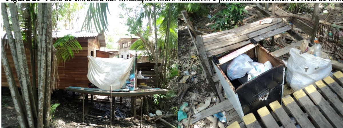
Figura 21- Falta de estrutura nas instalações hidro-sanitários e problemas referentes a coleta de lixo.
