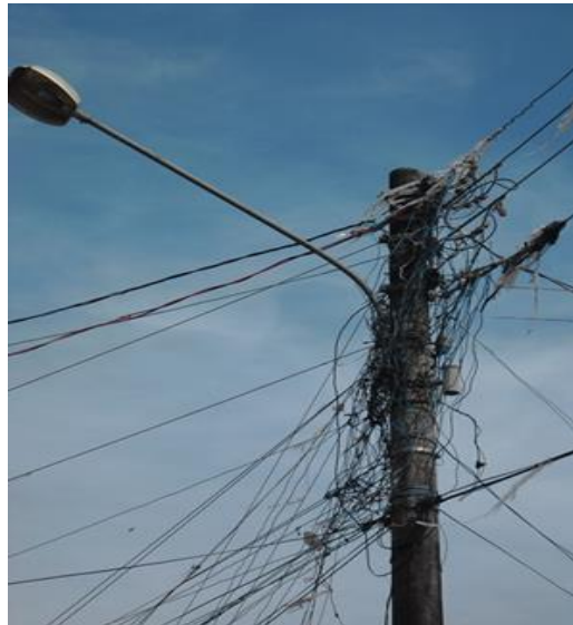
Figura 27: Má condição do fornecimento de energia Fonte: O autor, 2014.
