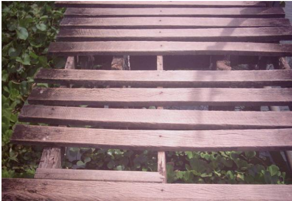
Figura 42: Péssimo estado das passarelas.
