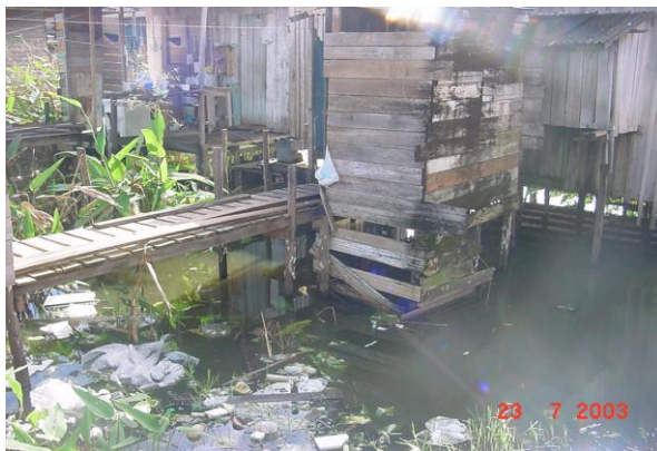
Figura 05: Lixo e falta de saneamento
