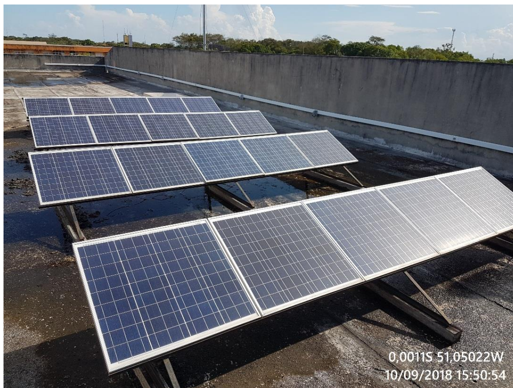
Figura 19 – Gerador fotovoltaico utilizado nos testes de laboratório.
