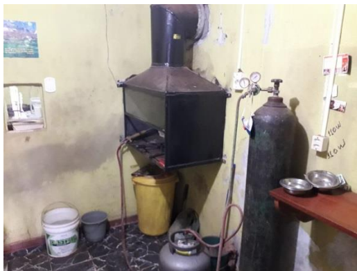
C-Condições dos materiais nas oficinas.
