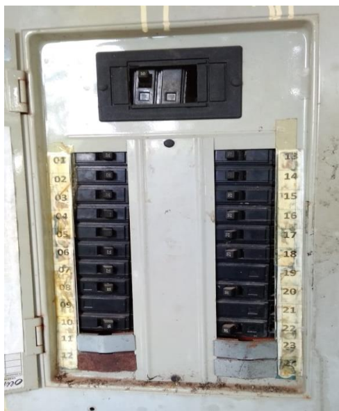
Figura 4 – Disjuntores mal dimensionados para a demanda da escola.
